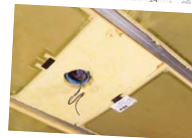
Emplacement de luminaire
